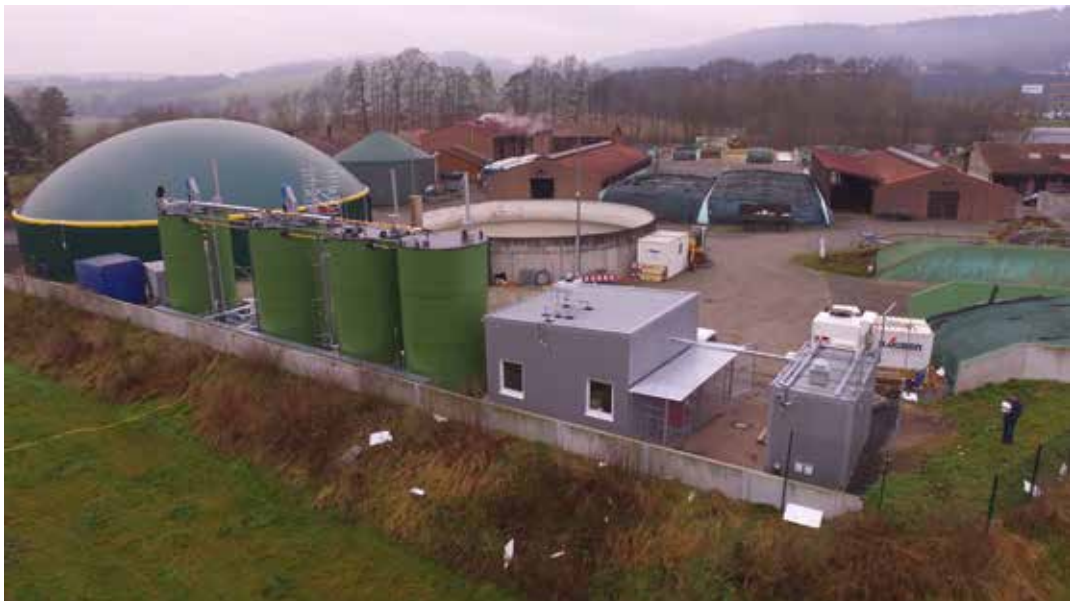
Abb. 3: Testplattform des Fraunhofer IEE mit hochflexibler Biogastechnologie (ReBi, links im Bild) und Power-to-Gas Testzentrum mit Elektrolyse (rechts im Bild) (© Fraunhofer IEE)
